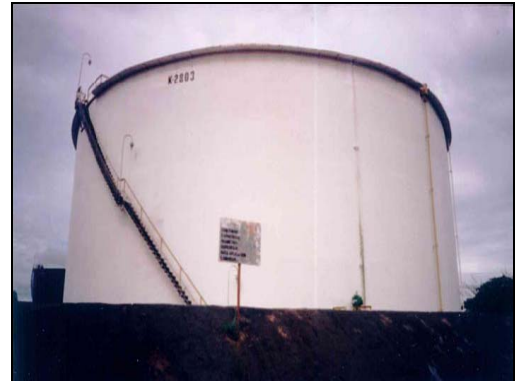
Figura 1-6 Estanque a Presión Atmosférica
