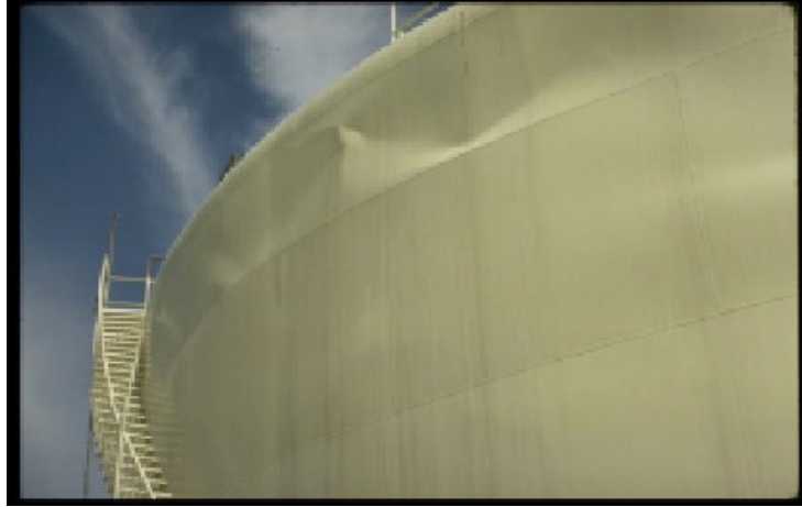
Figura 2.3 Falla de la parte superior de la pared por “sloshing”. (Fuente: Colección Steinbrugge. EERC, U.C. Berkeley)
