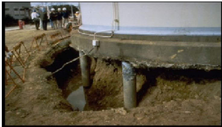
Figura 2.4 Falla de la fundación por licuación. (Fuente: Colección Steinbrugge. EERC, U.C. Berkeley)
